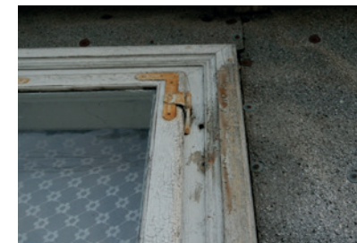
Oblistowanie okna, Osieck, gm. Osieck
